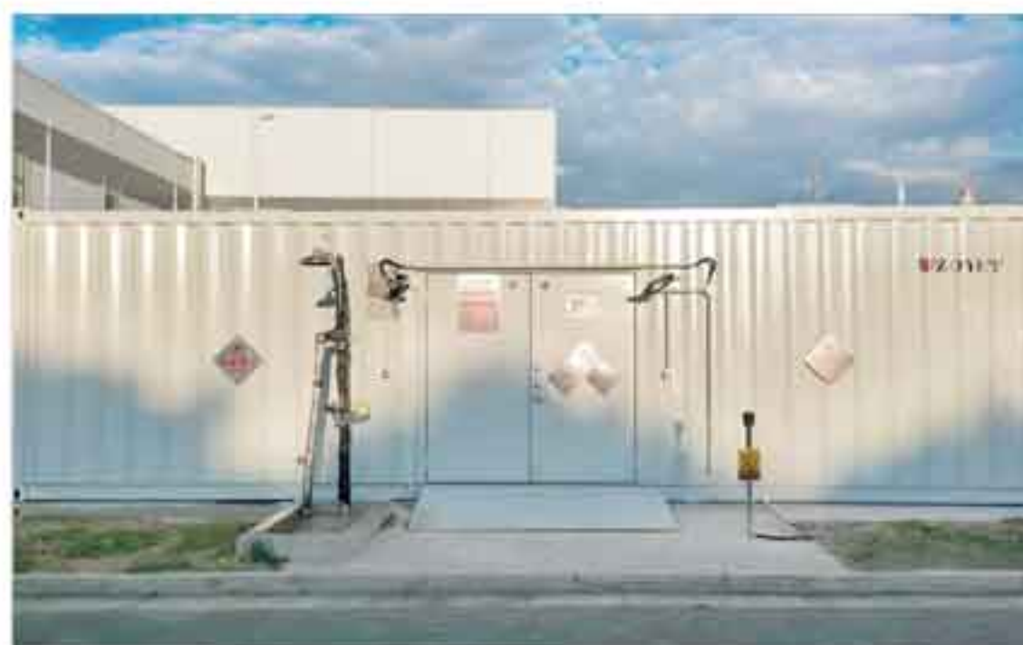
环晟光伏项目
