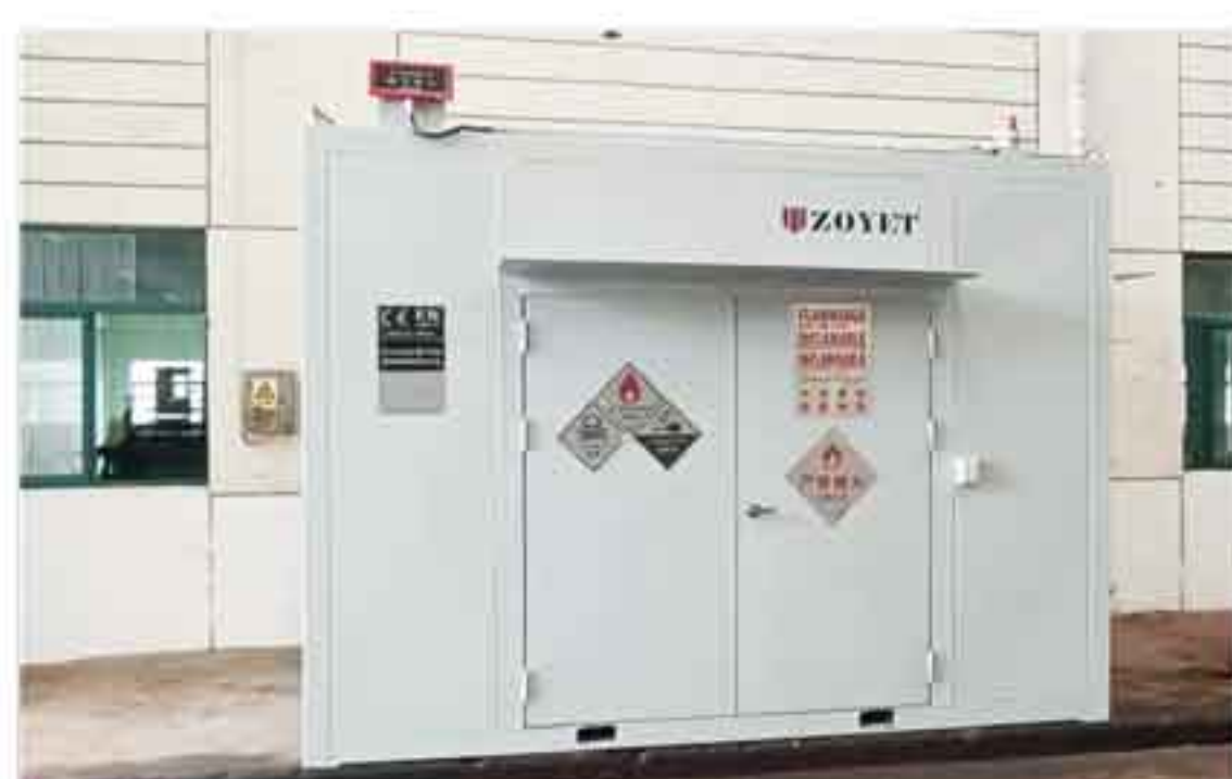
丰实电气项目
