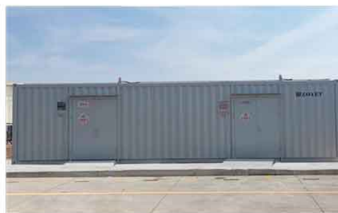
中石化胜利油田项目
