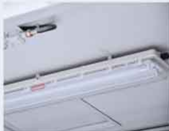
防爆照明系统
